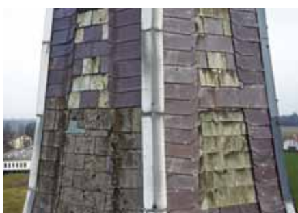
Aktueller Zustand Kirchturm Filialkirche Bogenhofen
